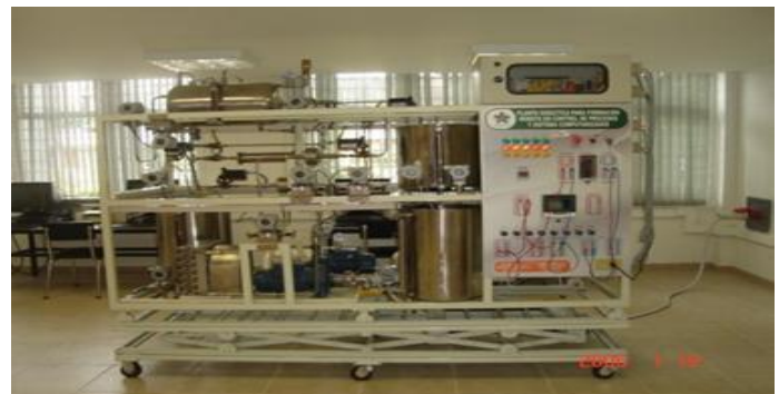
Figura 1. Foto planta industrial del CEAI
